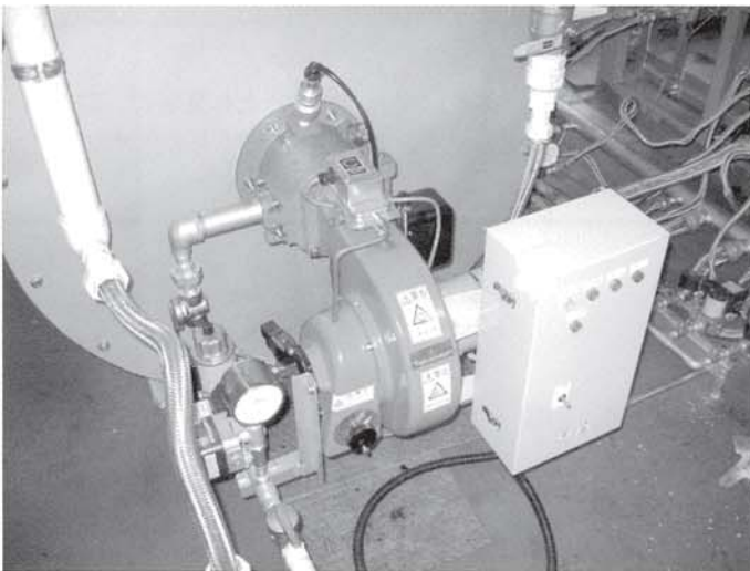
ELタイプ溶解槽脱臭装置燃焼設備
