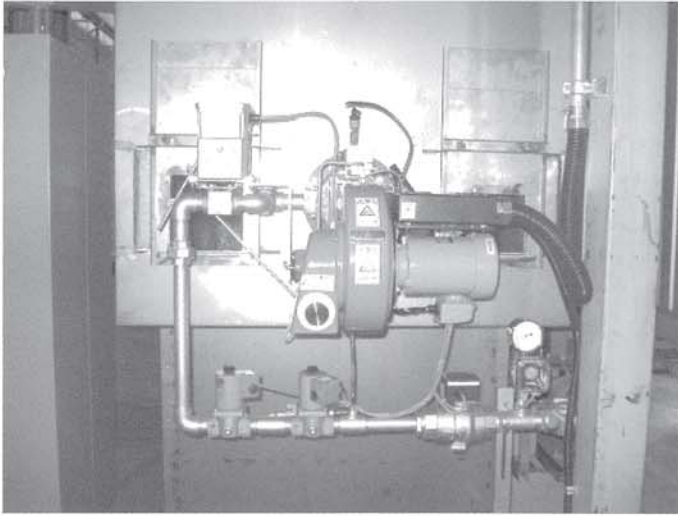
ELタイプ塗装乾燥装置燃焼設備
