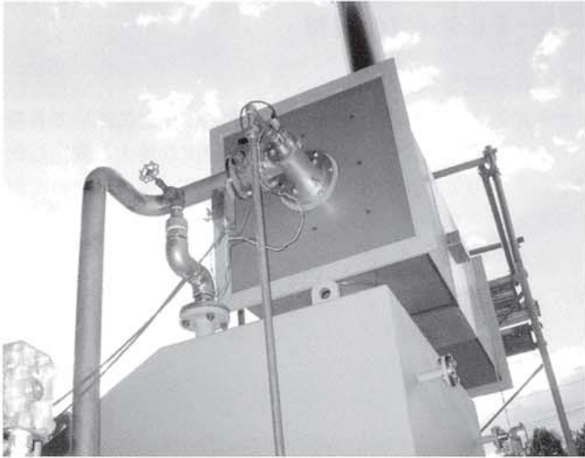
TBG炭化炉燃焼設備
