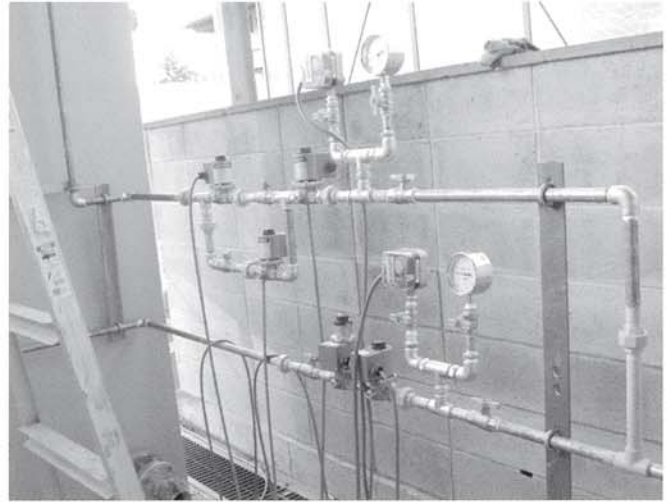
TBG炭化炉燃焼設備
