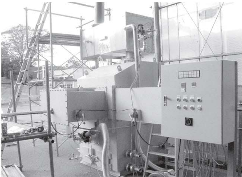
TBG炭化炉燃焼設備
