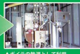
▲ボイラの熱源として利用
