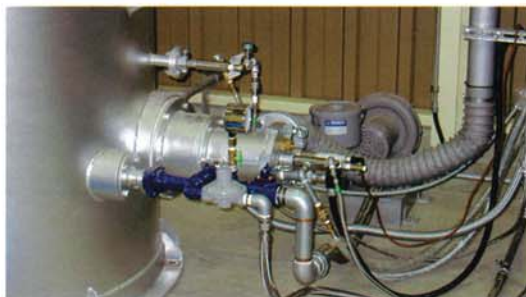
▲廃油・廃水・排ガス 特殊混焼バーナー
