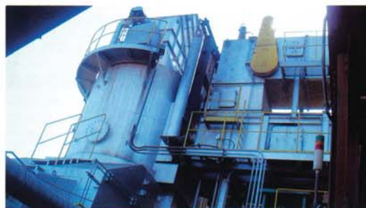
▲焼却設備の外観
